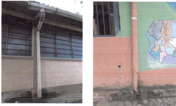
Foto 3: Sustitución de canal de pvc y Sustitución de bajada de agua pluvial de metal por tubo PVC 3"
