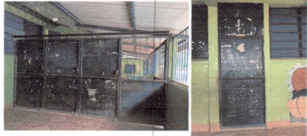
Foto 2: Mantenimiento a estructura (lijado, cambio de tubo , cepillado, aplicación de pintura) y mantenimiento a portones
