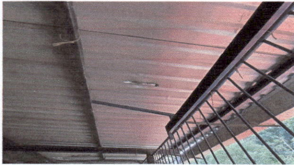
Foto1: Sustitución de lámina, por lámina troquelada aluzinc calibre 26. En corredor, baños y bodega
